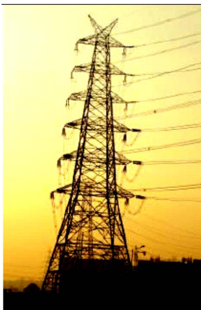
Рис.1. Опора четырёхцепной ВЛ 400 кВ
