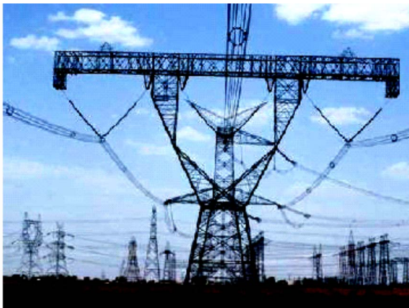
Рис.2. Опытный участок ВЛ 1200 кВ переменного тока
